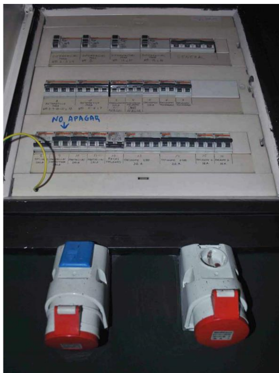
Imagen 4: Tomas de corriente, cuadro y automáticos de luz de sala
